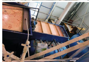
Рис. 2. Общий вид оборудования (а, б) для очистки сточных вод лакокрасочного производства
